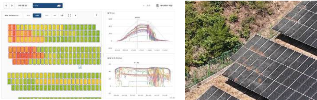
오염으로 인한 발전저하 추적 (경북 상주, 490kW)
